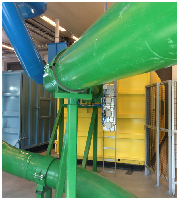
Vid stationär sopsug lagras avfallet i containrar som sedan transporteras med lastväxlare till en anläggning för avfallsbehandling. FOTO: ENVAC
