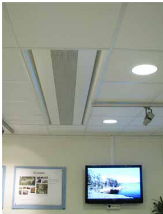
Ventilation i kommunens Servicecenter.
